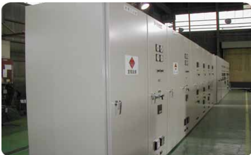
高圧受電盤から一式の受変電設備
