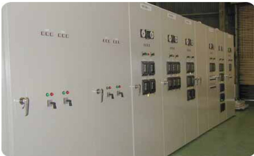
低圧配電盤類
